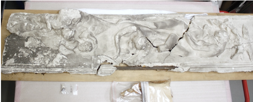
Figure 5 : relief avant les interventions de conservation-restauration de 2017, cassé en trois fragments principaux, avec des lacunes (des bords moulurés notamment), d'importants réseaux de fissures, des surfaces boursoufflées et pulvérulentes en partie basse causées par la présence de sels solubles, ainsi que des salissures hétérogènes © Musée Rodin – J. Robin Dupire
